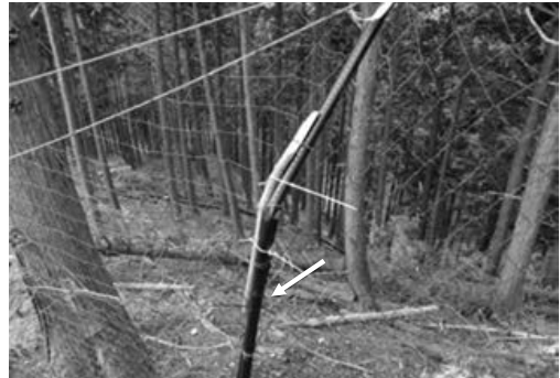
写真-4 添え木（矢印）による支柱折損部分の応急処置
