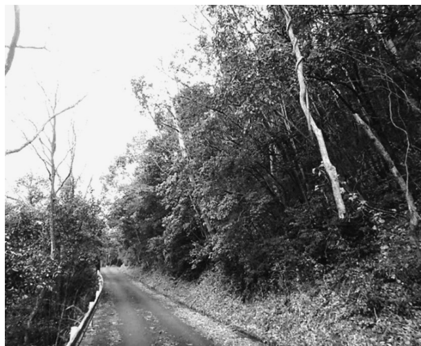
写真-1 倒木対策事業地の例（施工前）
