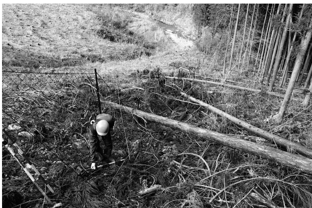
写真-1 倒木により倒壊する防護柵
