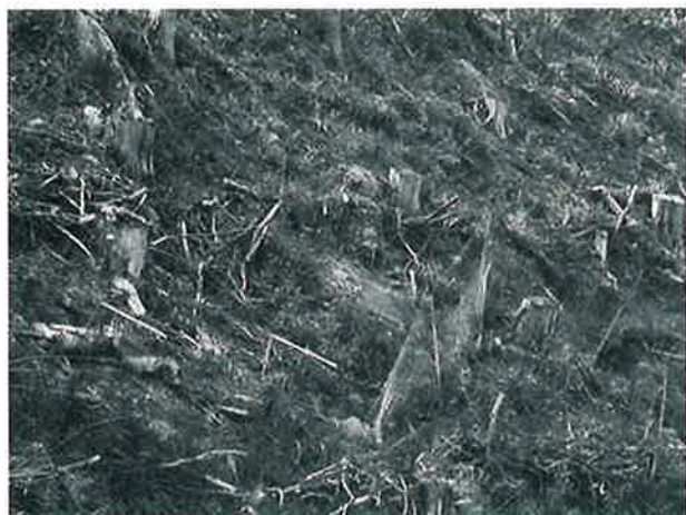
写真-2 気象害による防護柵の破損
