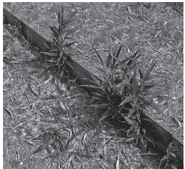
写真-11 遮蔽板に遮られ、遮蔽板に沿って内側（手前左側）に発生する小竹
