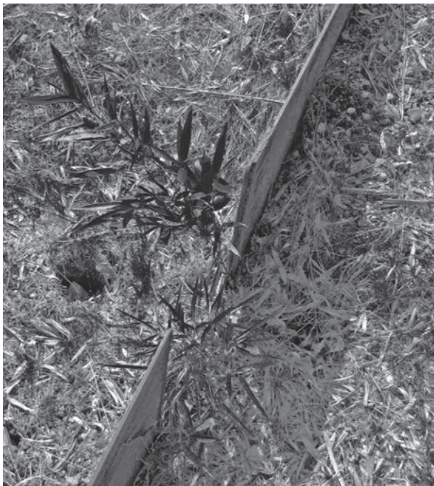
写真-12 遮蔽板の隙間から地下茎が伸長し、外側（左側）に発生した小竹
