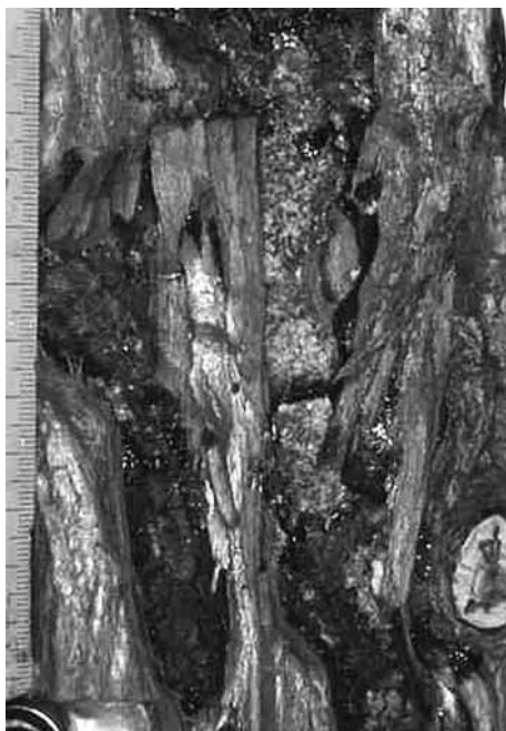
写真-1 スギカミキリの被害
