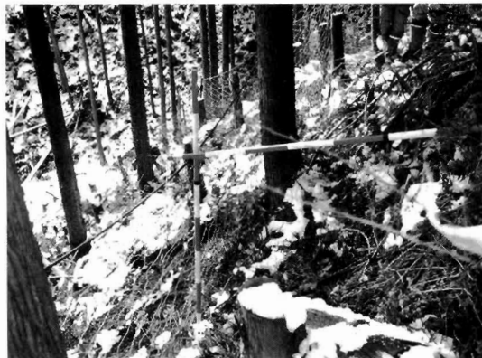
写真-2 急傾斜地に設置された防護柵。高さが1.2m程度と低だけでなく、少し斜面上部に移動するだけで障壁としての高さが保てなくなる。
