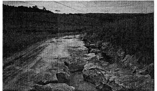
写真-9 路幅の半分が削られている国道
