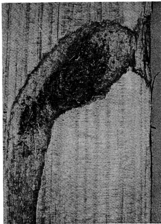
写真一3 キツツキ類(コゲラ)の啄食痕の断面
